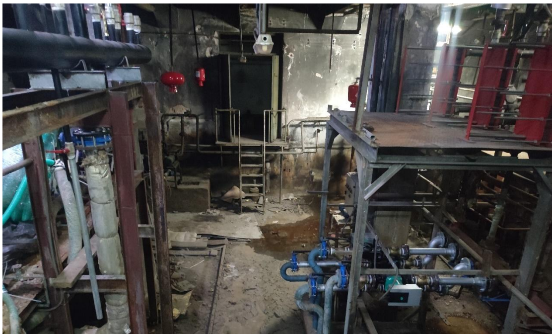
Εικόνα 17: Λέβητες υψηλής πίεσης
